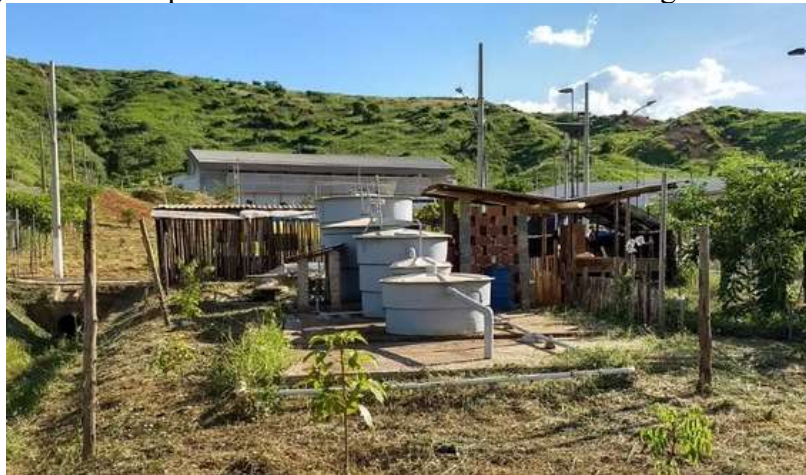
Figura 3: Vista parcial do Sistema de tratamento de esgoto IFMG-GV
