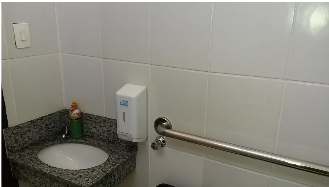
Figura 12 - Detalhe do banheiro para P.N.E. - Barras de apoio instaladas.
