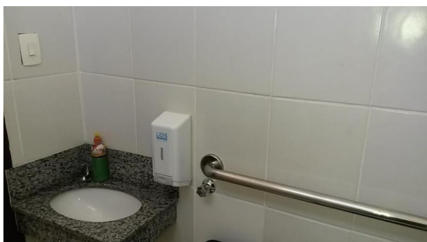
Figura 7 - Detalhe do banheiro para P.N.E. - Barras de apoio instaladas.
