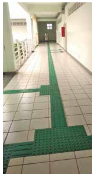
Pisos táteis instalados nos corredores do Campus Arcos
